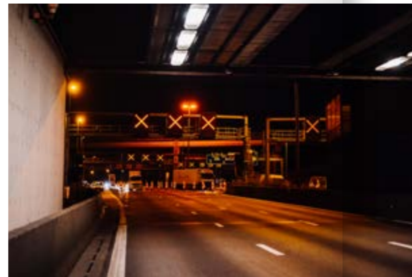
R1 Antwerpen, verlichting en wandplaten in Kennedytunnel
